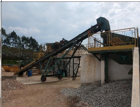
Foto 116: Esteira para resíduos triturados (15/09/2021).
