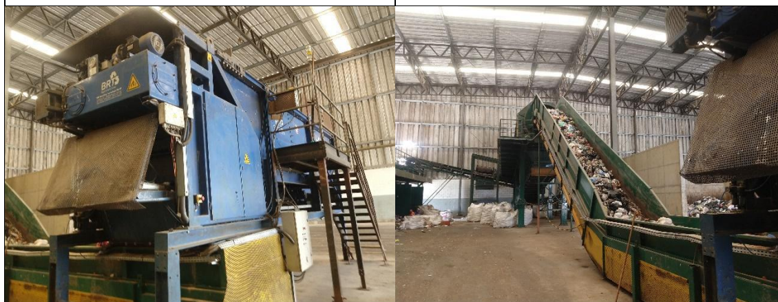
Foto 30: UTMB - esteira rolante para os resíduos não triados (15/09/2021).
