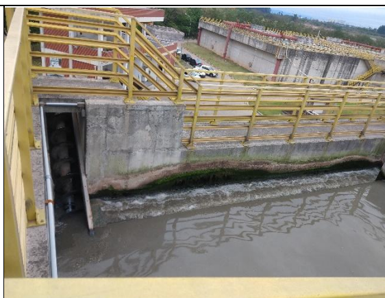
Foto 80: Caixa de areia na ETE Central (16/09/2021).
