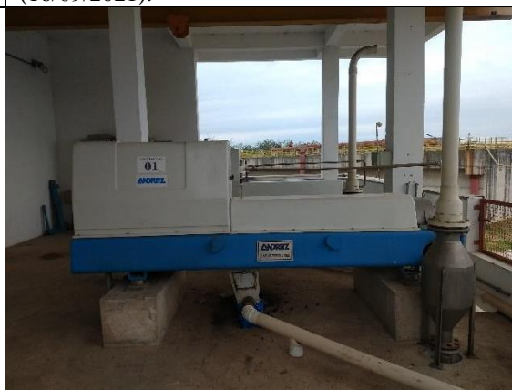
Foto 84: Centrifugas utilizadas no desaguamento do lodo na ETE Central (16/09/2021).
