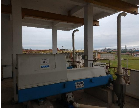
Foto 85: Centrifugas utilizadas no desaguamento do lodo na ETE Central (16/09/2021).
