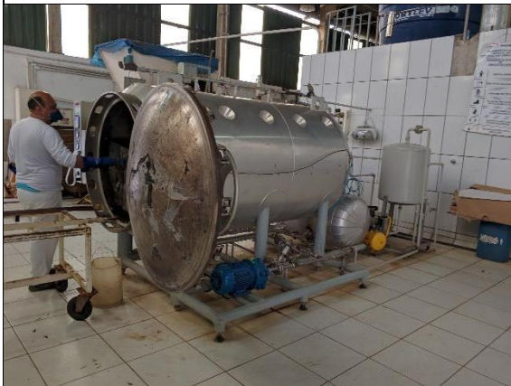
Foto 92: Operação da autoclave (15/09/2021).
