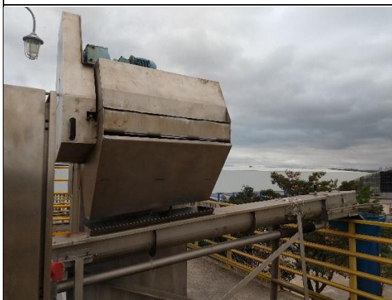
Foto 81: Rosca sem-fim utilizada para remoção da areia na ETE Central (16/09/2021).
