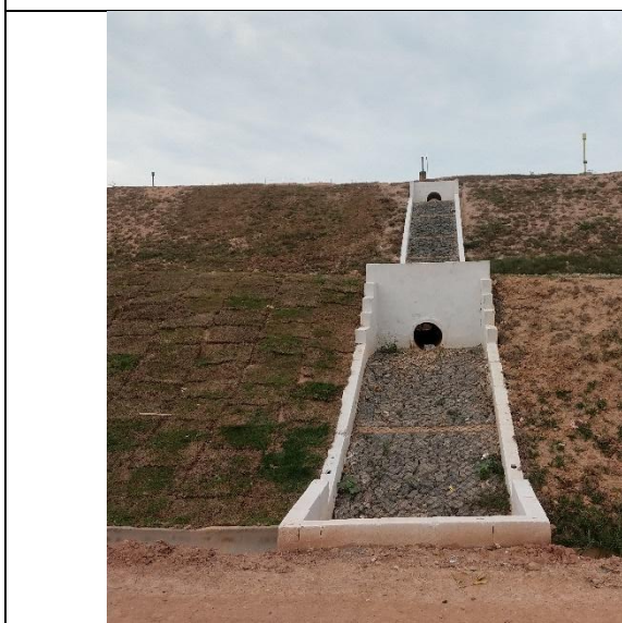
Foto 60: aterro sanitário em operação - sistema de drenagem de água superficial (15/09/2021).
